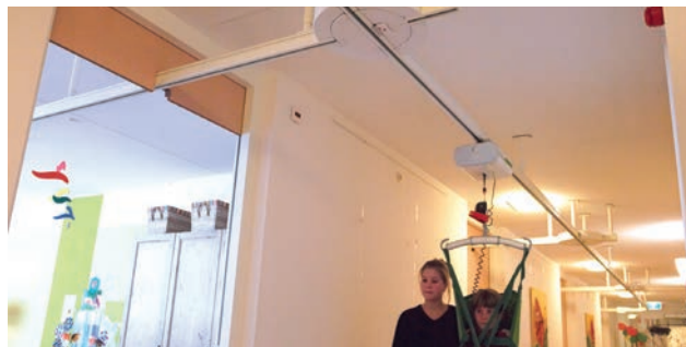
Monorailsysteem met rotonde en brandwerende deurdoorvoer.
